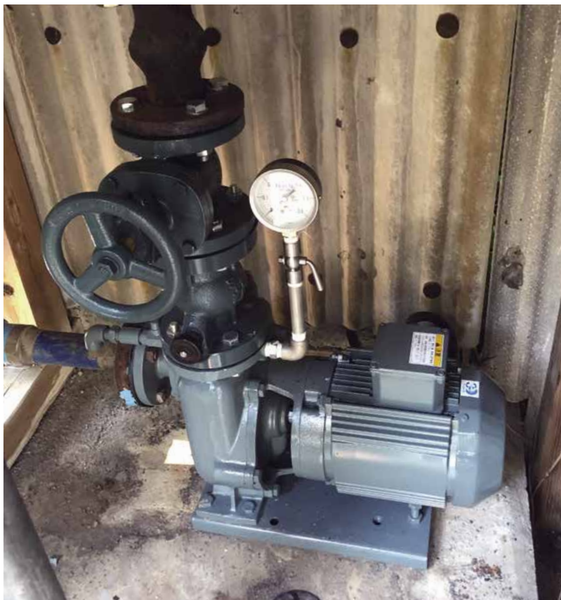
修理されたプール用水揚げポンプ（硫黄島）
