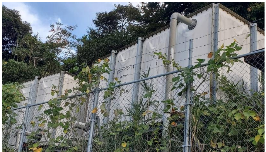
【配水タンク（片泊）】
