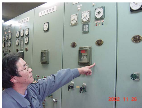
黒島発電所の様子
